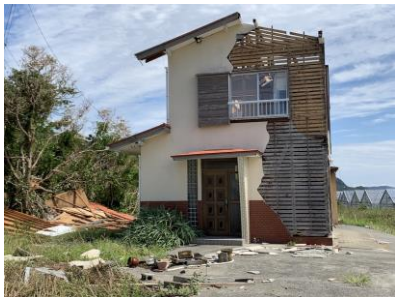
強風で破壊された住宅
