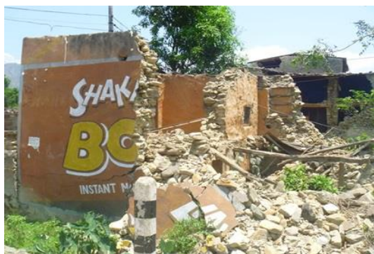
地震の影響で倒壊した家屋
