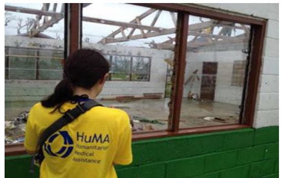
強風で屋根が吹き飛んだ学校
