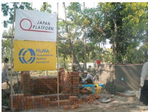
写真③ 井戸付帯設備建設中の様子(左からエンジン小屋、中央の青いパイプが深井戸、右に貯水槽)
