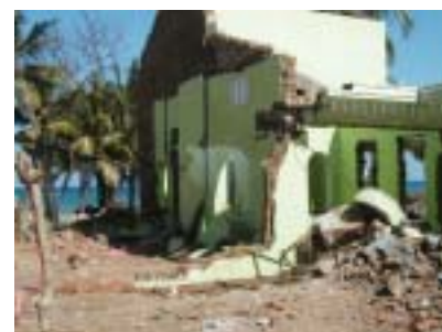
倒壊家屋の状況
