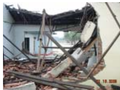
海岸沿いの倒壊した病院
